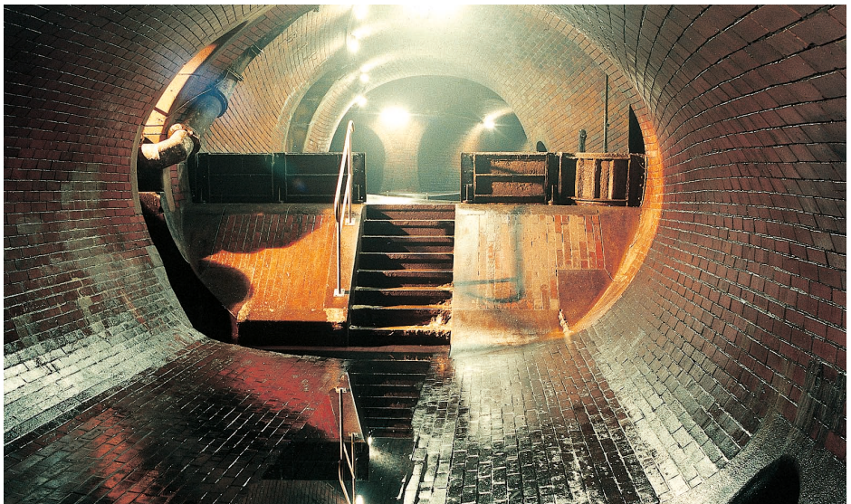
Stauraumkanal, Seestraße, Berlin (Quelle: Berliner Wasserbetriebe)
