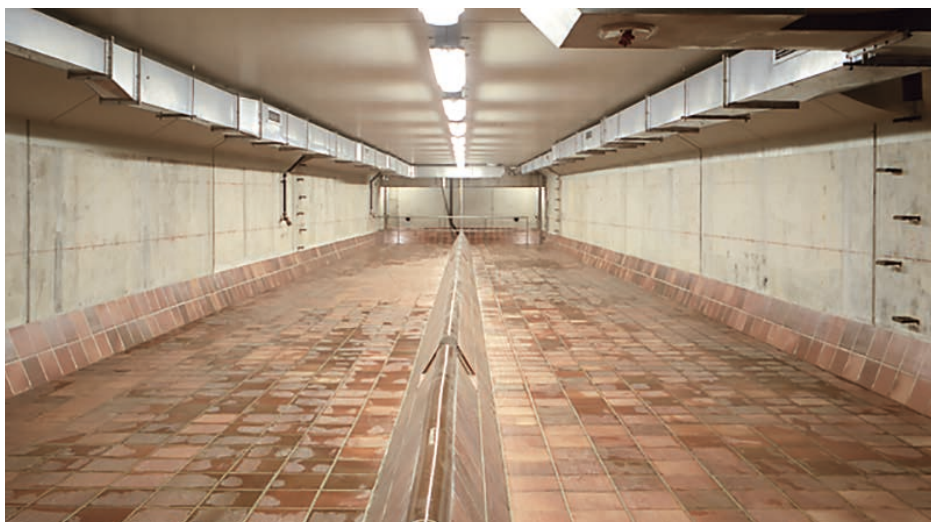
Regenklärbecken, Badeweg, Berlin (Quelle: Berliner Wasserbetriebe)
